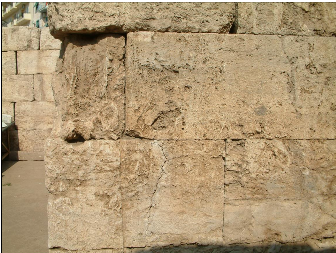
Επιφανειακές ρωγμές σε δόμους από πορόλιθο
