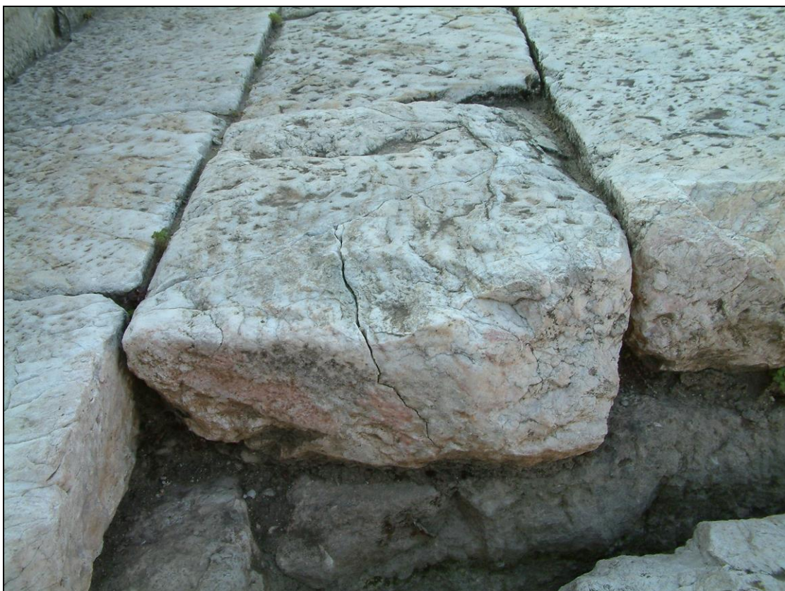
Ρωγμή σε εδώλιο
